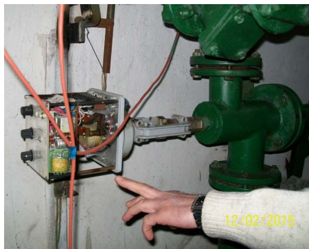
Рисунок 2 – Фотографія, що показує розміщення ЕлБ у теплому вузлі
